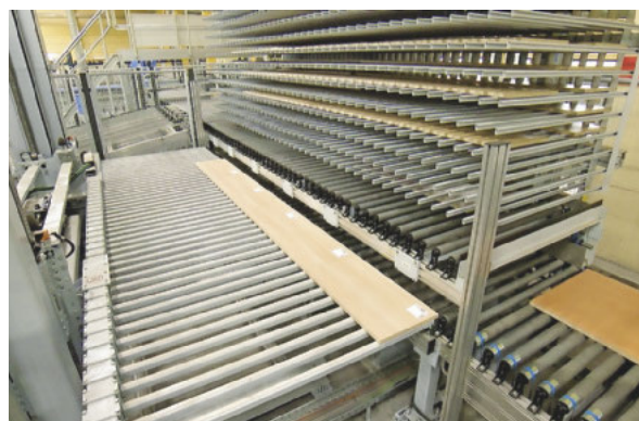
Lagenspeicher vor der Bekantungszelle
