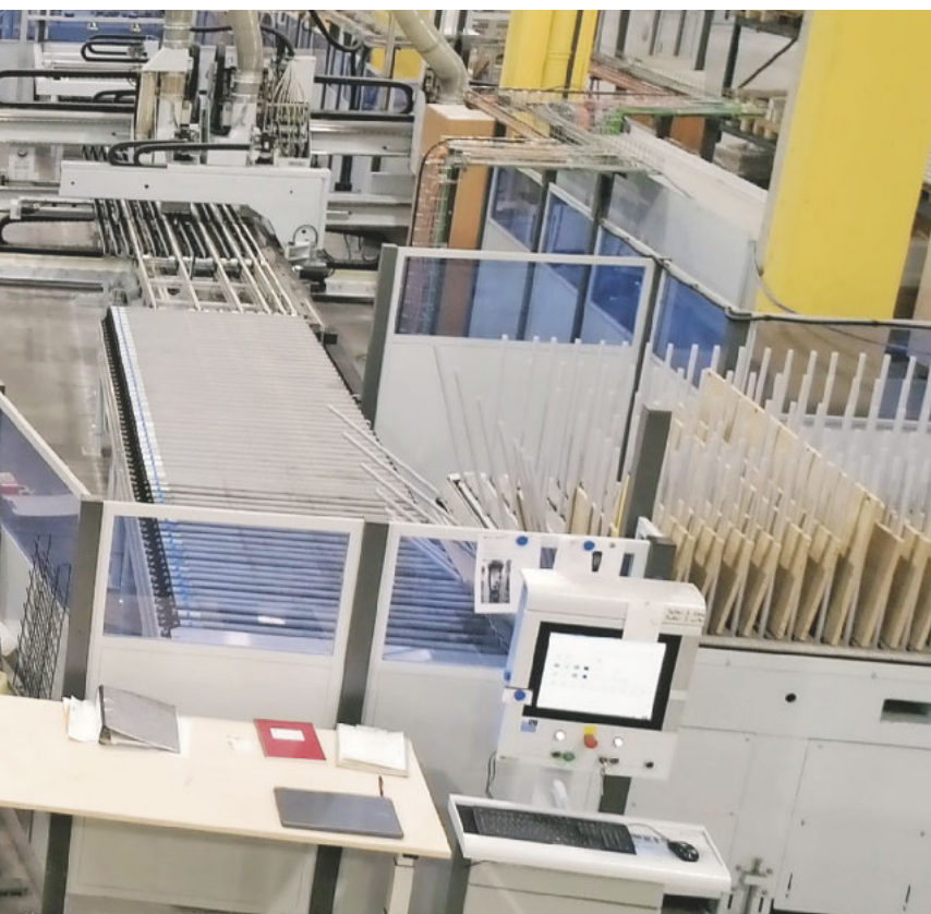
Die 166 m lange Produktionslinie bei Goldbach Kirchner verkettet das Plattenlager direkt mit der Montageabteilung
